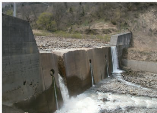
▲ラバースチール設置なし (経過年数10年※コンクリートにて天端補修後 最大約10mの摩耗) (位置：右記砂防堰堤の下流)
