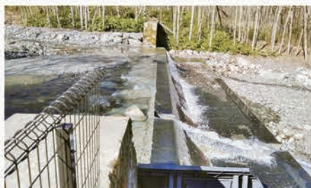
▲(株)グリーン電力エンジニアリング(小水力発電) 奈良井川萱ヶ平取水口(長野県)
