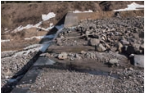
▲ラバーsteel設置状況(RS-F50、RS-C50) (平均摩耗速度0.26mm/年、経過年数18年時)
