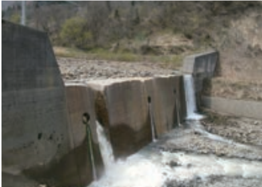
▲ラバーsteel設置なし (経過年数10年※コンクリートにて天端補修後 最大約10mの摩耗) (位置：右記砂防堰堤の下流)
